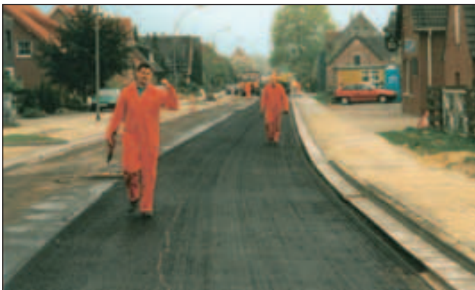
Installatie van HaTelit® , Ochtrup Duitsland, 1996
